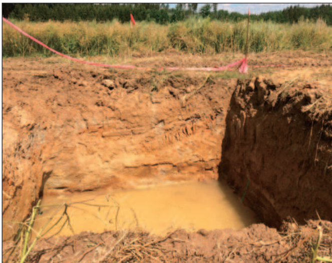
Jáma provedená v rámci takzvané opravy (výměny stožárů) nadzemního vedení vysokého napětí. V jámě je nateklá voda z porušených drenáží
